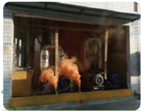
鍋爐房熱煤油蓄熱桶泵浦 1# 煙感觸發火警，熱煤油主機觸發消防警報，演習開始
